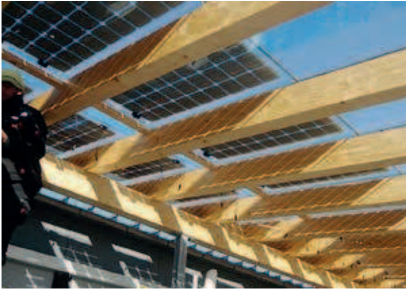
Photovoltaik-Eigenverbrauchsanlage an der Heideschule Mutlangen
