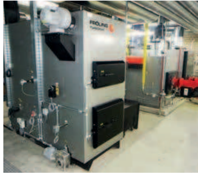
Neue Wärmeversorgung am KBSZ Schwäbisch Gmünd
